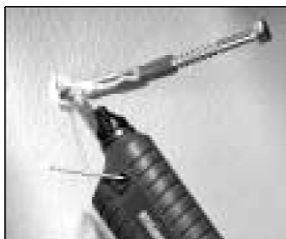
Крепление слабо установленных дюбелей
