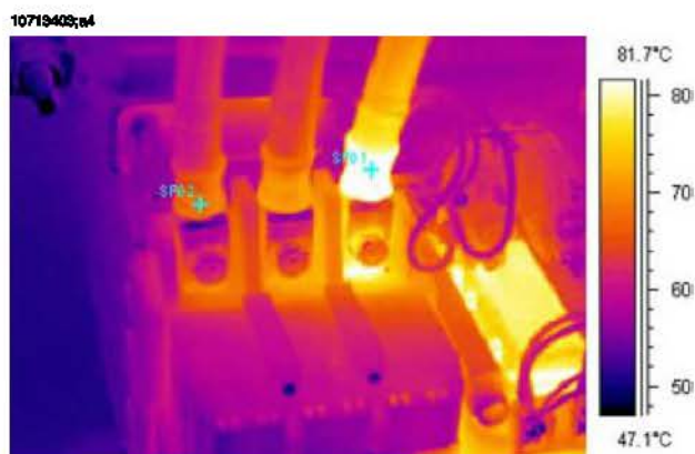
Рисунок 28.8 ИК-изображение электрооборудования внутренней установки (1).
