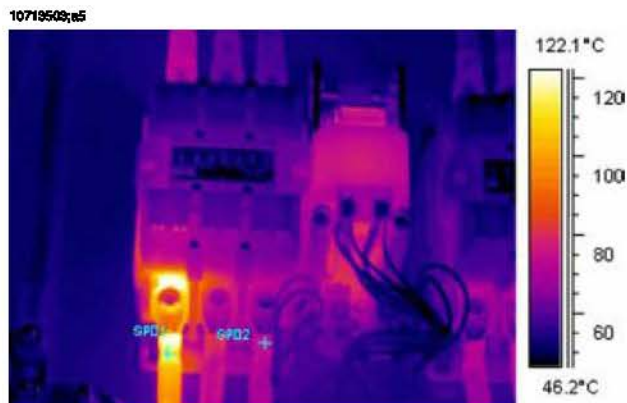
Рисунок 28.9 ИК-изображение электрооборудования внутренней установки (2).
